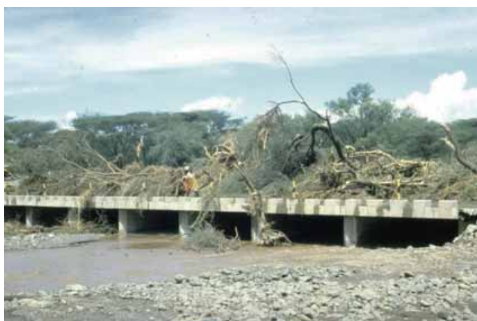
Figure 5 Débris et sédiments envahissent les réservoirs d'eau Photo WOCAT
